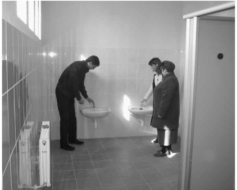
■ Bildaufnahme der fertig gestellten Toilette für Jungen in der Schule Milestii-Noi. Ion, unser dortiger Helfer, zeigt zwei Lehrerinnen wie alles funktioniert.
