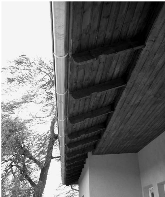
■ Dachansicht der Vordereingangs. Nach langer Diskussion sind nun die Regenrinnen richtig angebaut worden.
