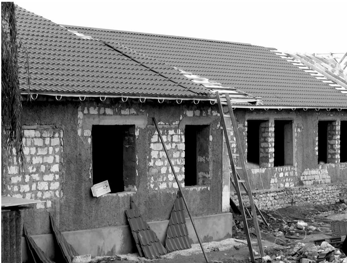
■ Das Dach der gesamten Schule wird mit grünen Metalldachziegelplatten gedeckt. Die Halterungen für die Regenrinne sind bereits montiert.
