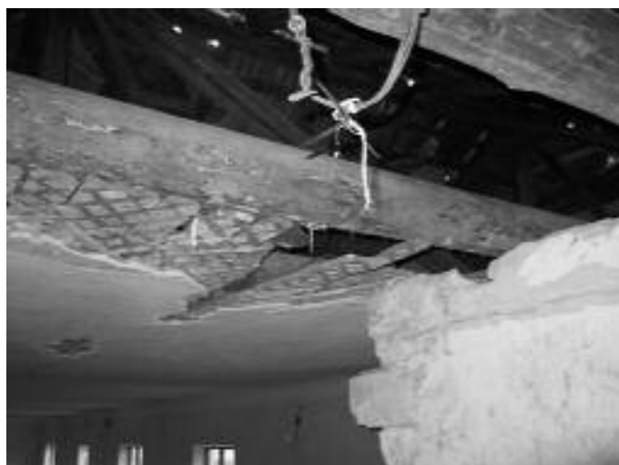
Die Decken müssen neu erstellt werden.
