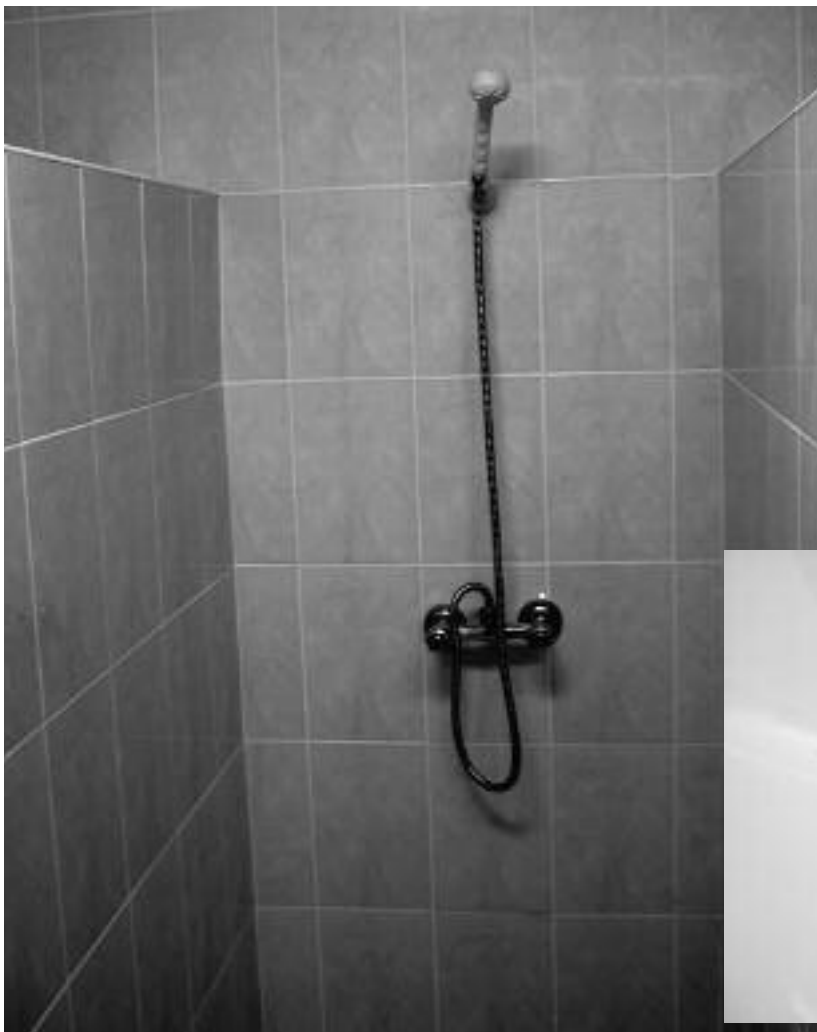
Eine der neugeschaffenen Duschkzellen in Leova. Nur hier ist auch warmes Wasser vorhanden.
