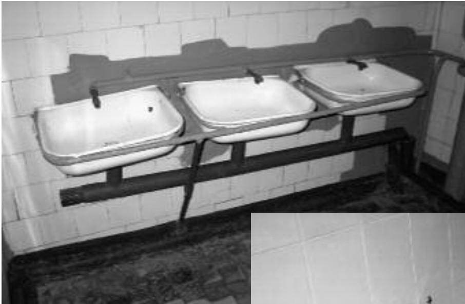
↑ Waschraum für die Mädchen in der Schule Leova vor der Renovation. Die Wasserhähne fehlen
