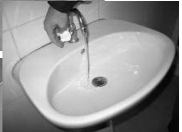
Das Wasser fließt dank des im Vorjahr durch den Rotary Club Zürich-Turicum finanzierten Tiefbrunnens in dieser Internatsschule. Aus Gründen der ständigen Stromrationierung ist für die Waschbecken nur kaltes Wasser vorgesehen.
