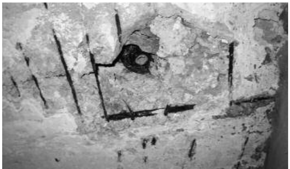
So sahen die Decken und Böden der Internatsschule in Leova vor Beginn der Baumaßnahmen aus. Bilder: M. Hänggi
