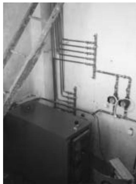
Heizkessel der Schule in Cabaesti. Zum Zeitpunkt der Aufnahme waren noch Montagearbeiten notwendig.
