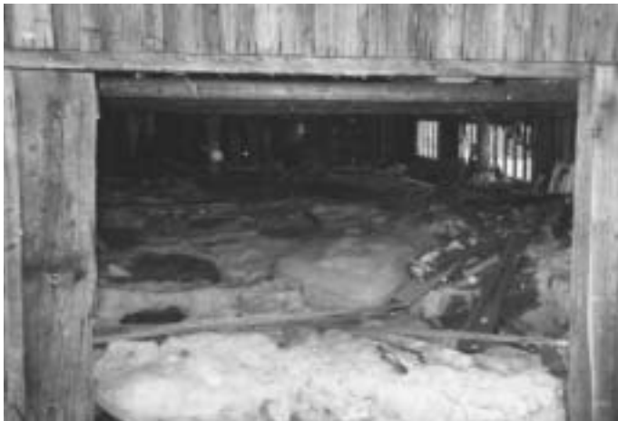
Eingang zu einer Gattersäge in Farcasa. Der Maschinenbestand ist eingeeist und vollständig zerstört.
