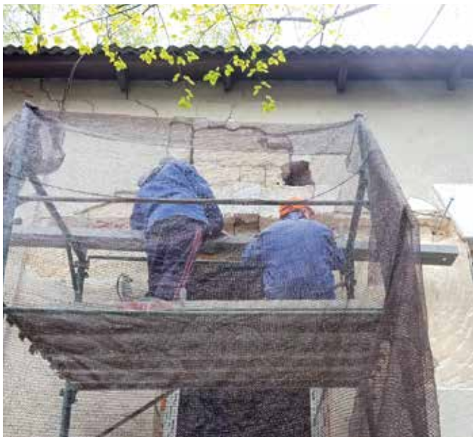
■ Das Eckgebäude dieser medizinischen Institution drohte wegzubrechen. Sowohl die Außen- als auch die Innenseite mussten mit Stahlträgern stabilisiert werden.
