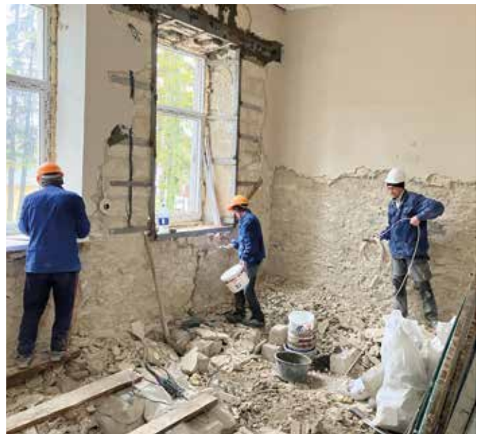
■ Die Bauarbeiter bei der Demontage der Innenwände und des Fußbodens. Bilder: Pro Humanitate
