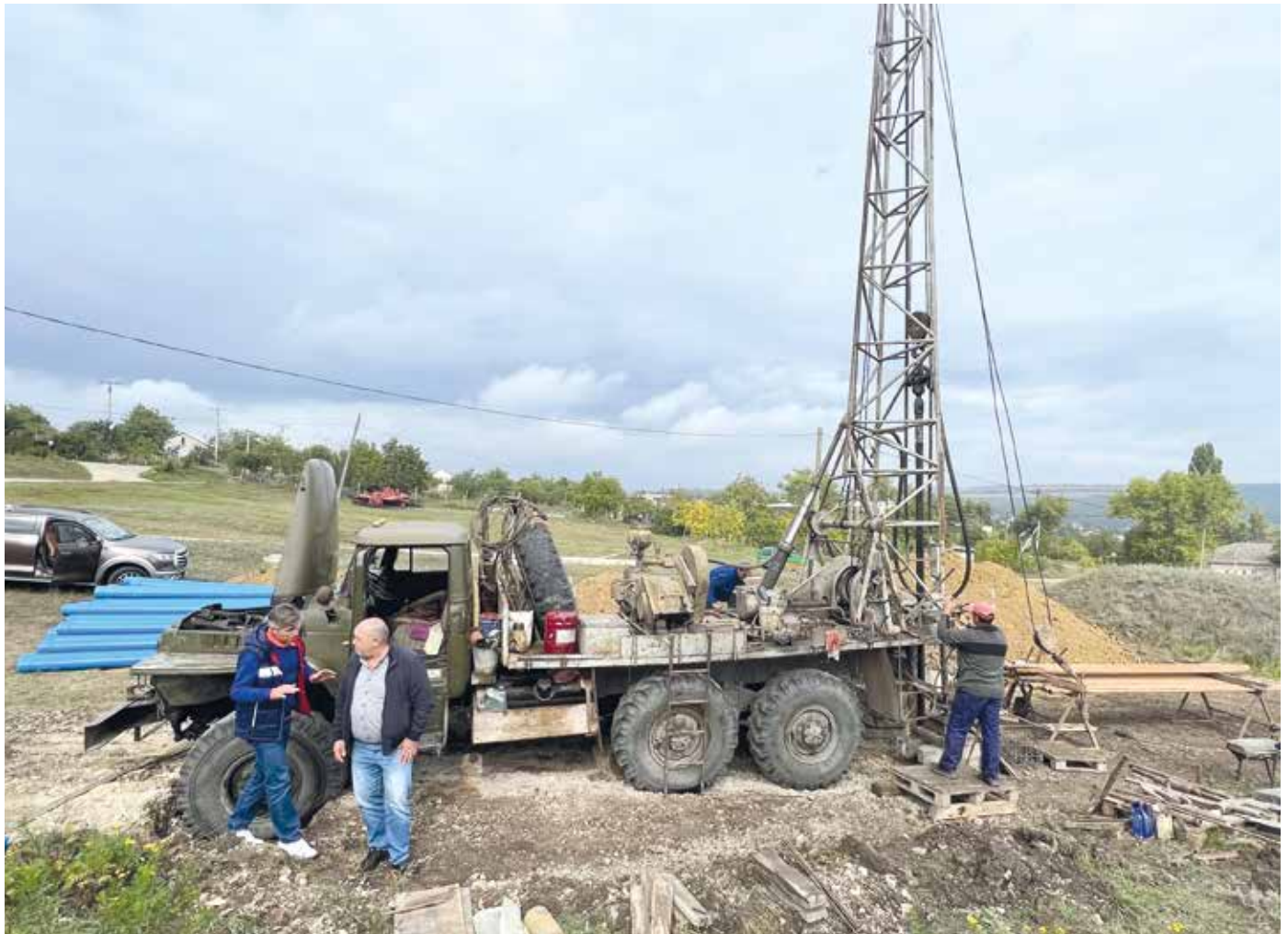
■ Unser Wasserbauingenieur Veaceslav Scutaru mit dem Bürgermeister von Varatic beim dritten und erfolgreichen Bohrversuch.
