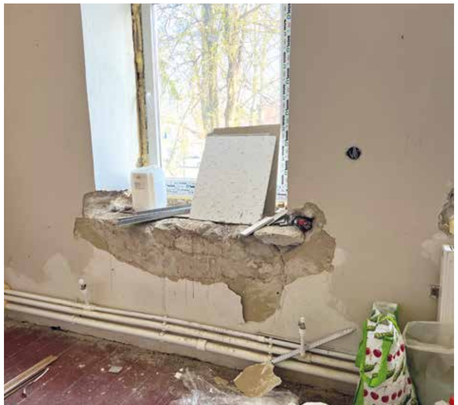
■ Das Mauerwerk dieses Gebäudes weist grobe statische Mängel auf. An vielen Stellen ist es brüchig, die Decke droht herabzufallen. Die Räumlichkeiten können nicht mehr benutzt werden. Bilder: Pro Humanitate
