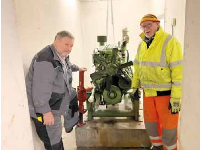
■ Im Bild rechts, unser treuer Mithelfer für schwere Arbeiten, Kurt Geiges, links, sein Kamerad Rolf Müller, beim Ausbau des Generators. Mit schweren Winden wird der Generator vom Fundament gehoben und auf Rollen gelagert.
