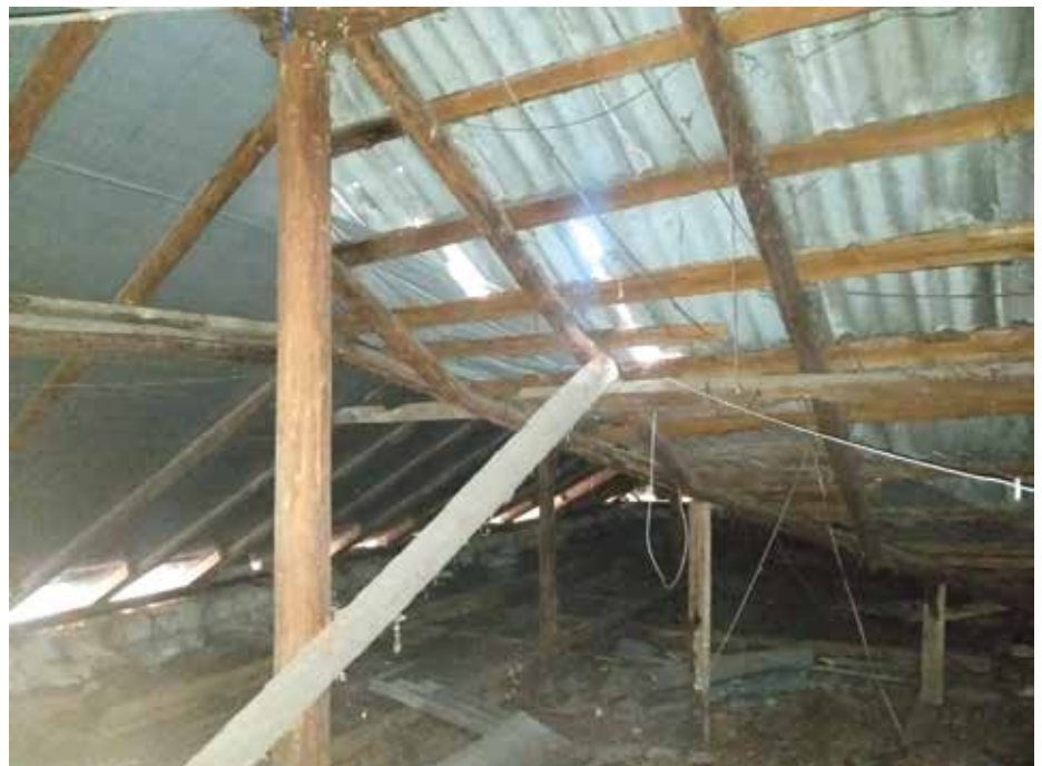
■ Selbst das notdürftig reparierte Dach dieses Ausbildungszentrums ist kaputt. Bilder: Pro Humanitate
