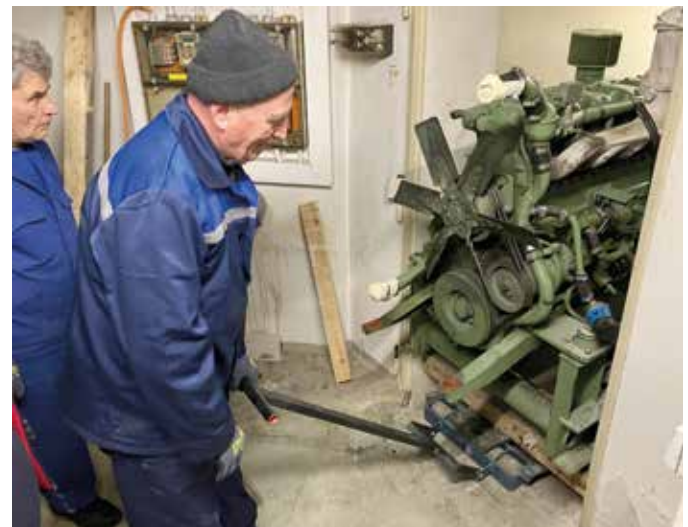
■ Zwei unserer zur Demontage aus Moldau angeforderte Hilfskräfte bei der Arbeit. Vergeblich versuchen sie den Generator durch die schmale Türöffnung herauszuziehen. Bilder: Pro Humanitate
