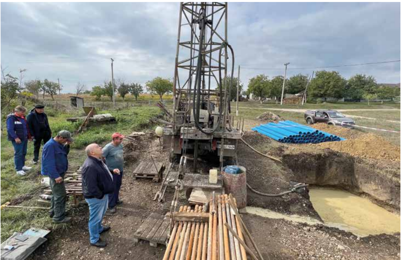
■ Die erforderliche Spülwassergrube ist bereits ausgehoben, Bohrgestänge und die Wasserrohre sind angeliefert, die Arbeiten sind in vollem Gange
