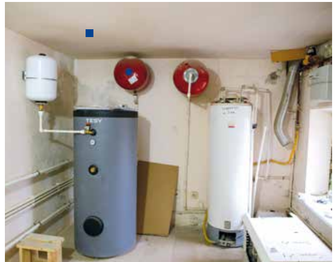
■ Die Heizung und Warmwasseranlage des Sozialzentrums
