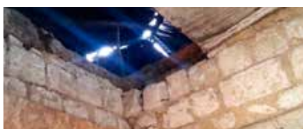
■ Unter diesen Umständen muss eine Mutter mit ihren drei Kindern über den Winter kommen. Wir sind dabei auch dieses Dach zu reparieren.
