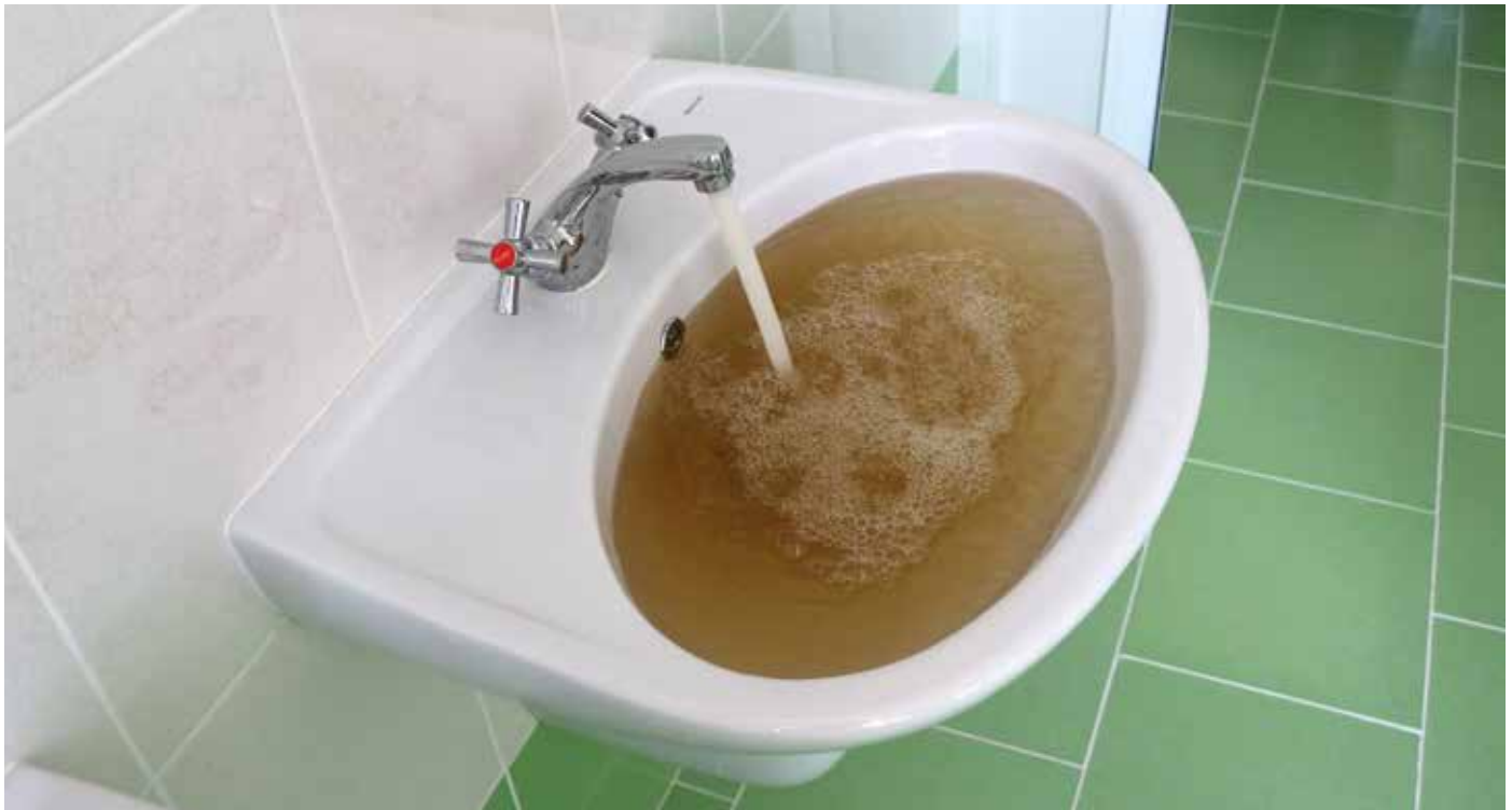
■ Die unglaubliche Brühe des sogenannten „technischen Wassers“ im Gymnasium Mingir.
