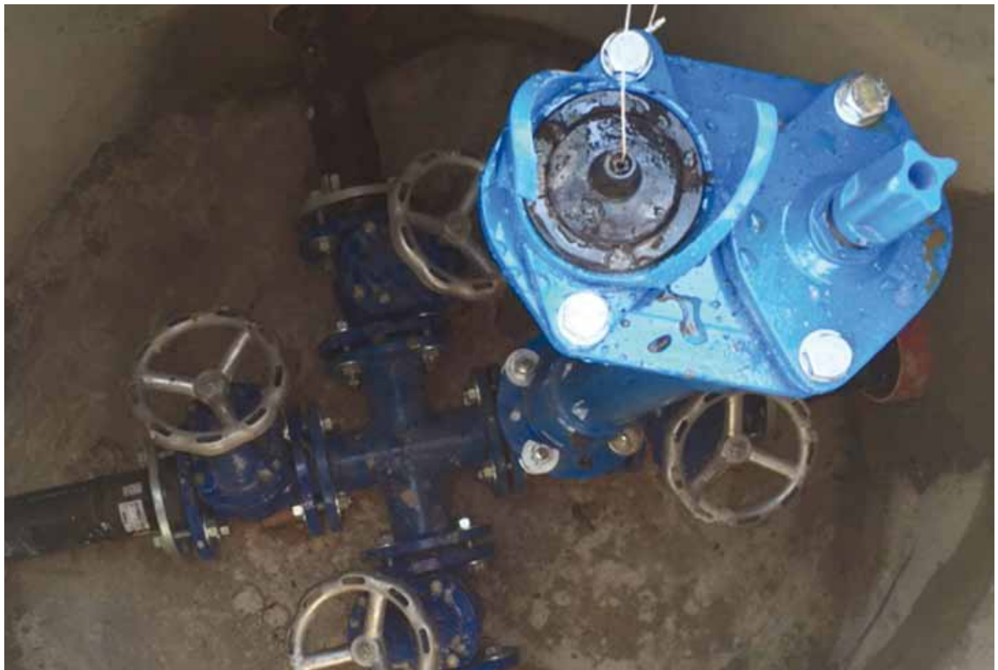
■ Das Verteilersystem der Tiefbohrung ist installiert und plombiert. Wasser darf entnommen werden.
