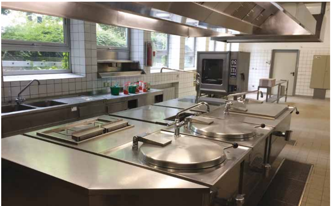
Die Kücheneinrichtung des Spitals in Rottweil steht uns ebenfalls zur Verfügung. Sie wird für weitere Küchenprojekte in Moldau verwendet. Drei Ingenieure aus Moldau kommen extra zur Demontage.
