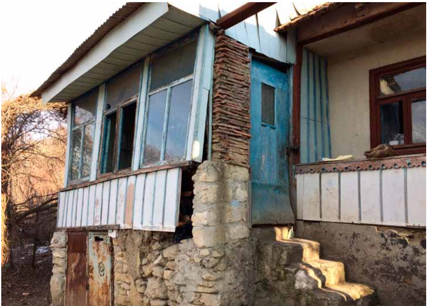
■ Das Haus bricht zusammen. Wegen der Hanglage besteht Lebensgefahr.
