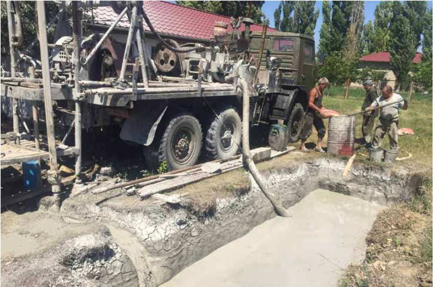
■ Bohrarbeiter im Einsatz. Hier ist die Grube für das Spülwasser der Bohrung zu erkennen.
