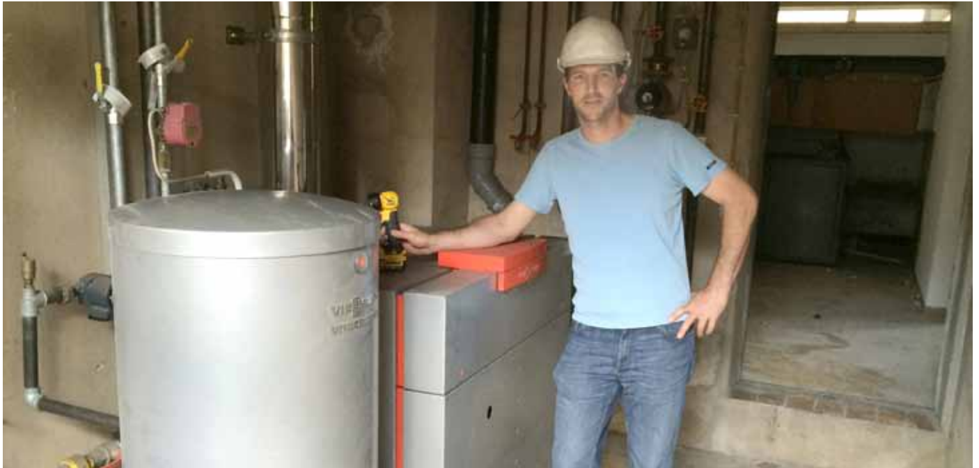
■ Der Installateurmeister Jörg Hörtnier aus Engen, vor der Demontage der Heizanlage des ehemaligen Hotels Paradis in Stockach
