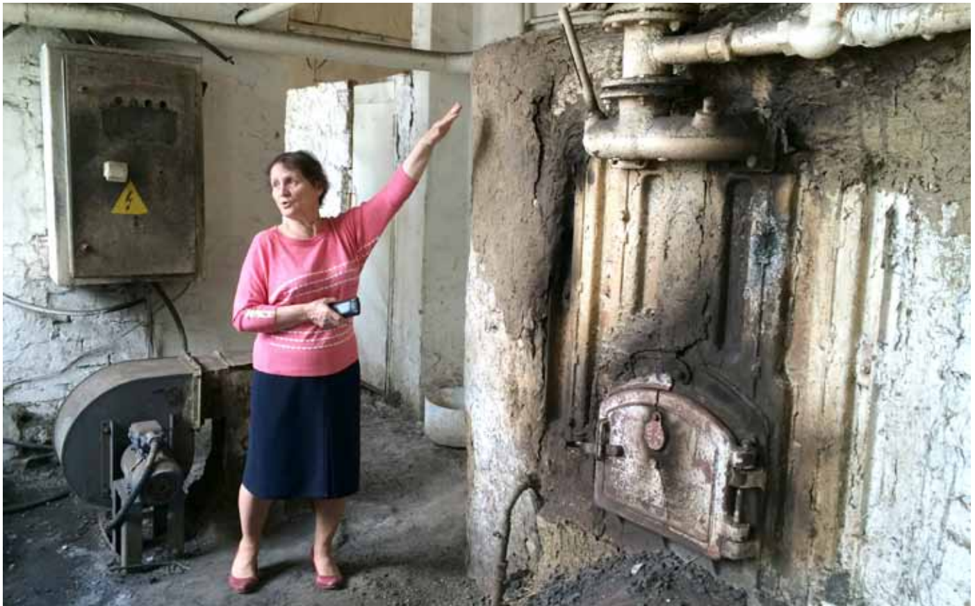
■ Die Direktorin der Schule in Hirova, Elena Spanu, zeigt uns voller Frust die Heizanlage der Schule welche mit Lehm geflickt wurde.
