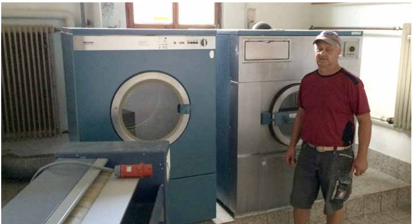
■ Die Industriewaschmaschine mit Trockner und Wäschemangel, vor dem Ausbau im ehemaligen Hotel Paradis in Stockach. Im Bild, der zuständige Polier der Baustelle, Edgar Völkel.
