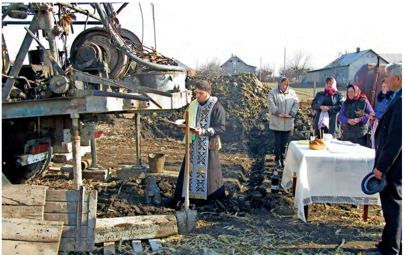
■ Vor Beginn einer jeden Tiefbrunnenbohrung ist es in Moldau üblich, dass der Ortsgeistliche um den Segen für die anstehende Arbeit und sauberes Trinkwasser bittet. Anwesend sind immer der Bürgermeister mit den Gemeinderäten und dem Bauleiter. Bilder: Ion Luchian
