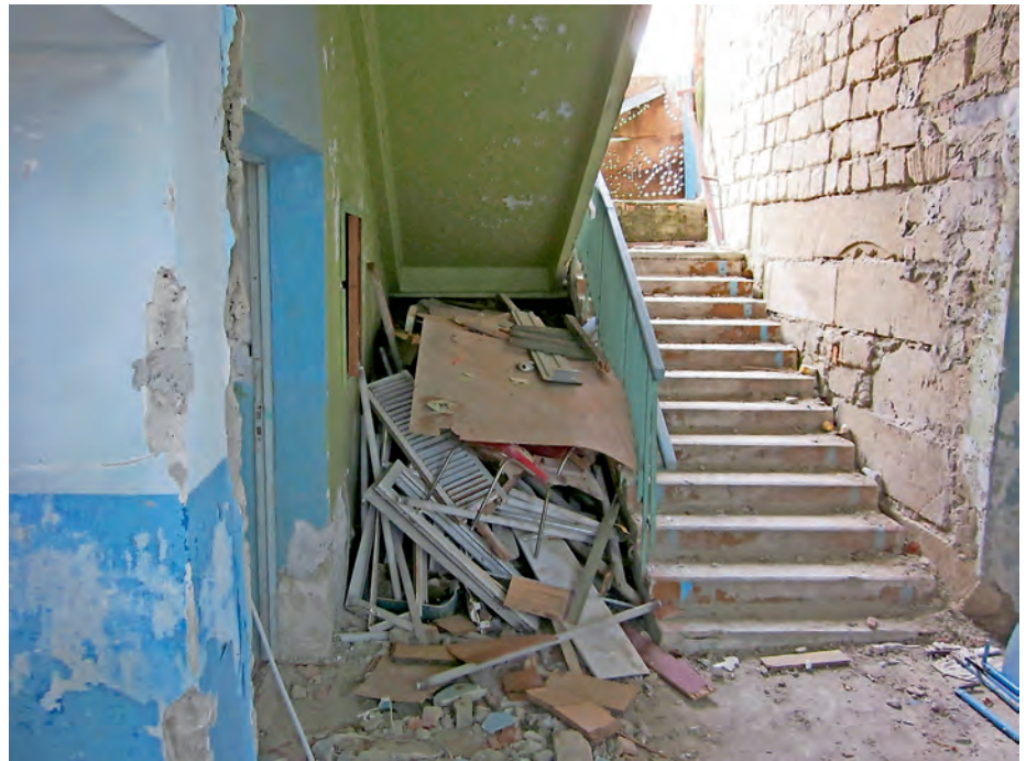
■ Der Eingangsbereich des Sozialküchenbaus vor der Instandsetzung. Angesichts des Zustandes könnte man mutlos werden. Dank unserer Spender wird hier wirklich viel verändert.
