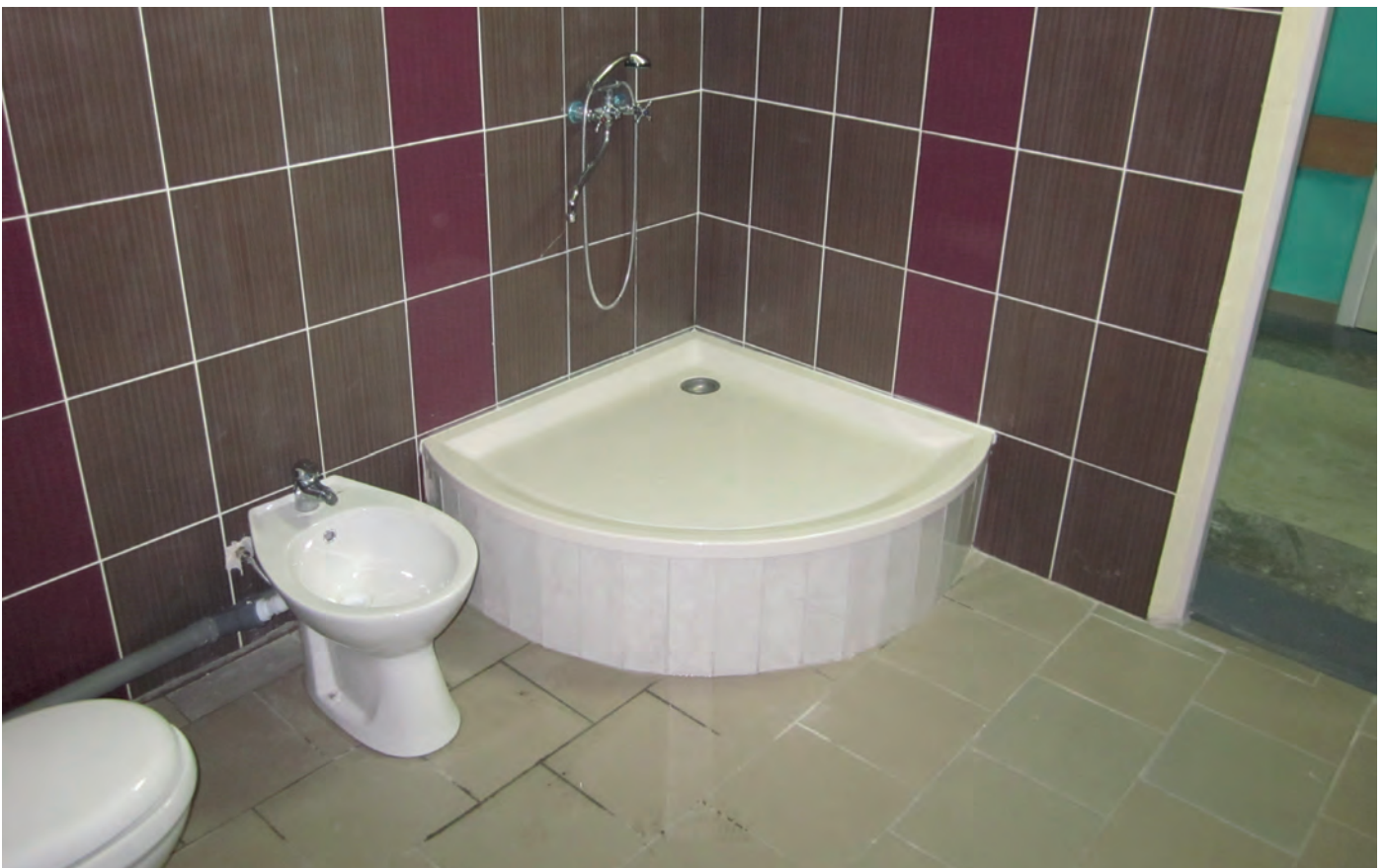
■ Das Bild zeigt eine in der Klinik Ignatenco vorbildlich sanierte Naßzelle mit Toilette, Bidet und Dusche. Die Hilfe von DURAVIT ist hier unverzichtbar. Bilder: PRO HUMANITÄTE
