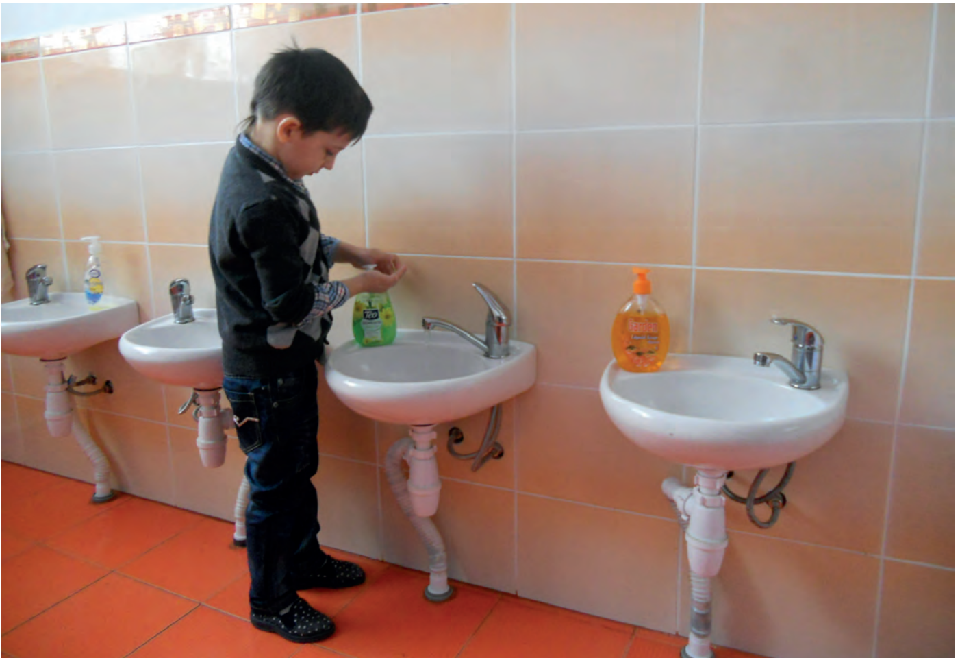
■ Bild aus einem durch unsere Hilfe mit Sanitärkeramik von DURAVIT renoviertem Kindergarten in Causeni/Moldau. Hier erlernen es Kinder sachgerecht mit Hygiene umzugehen. Moderne saubere Toiletten und Wascheinrichtungen sind hier vorhanden.
