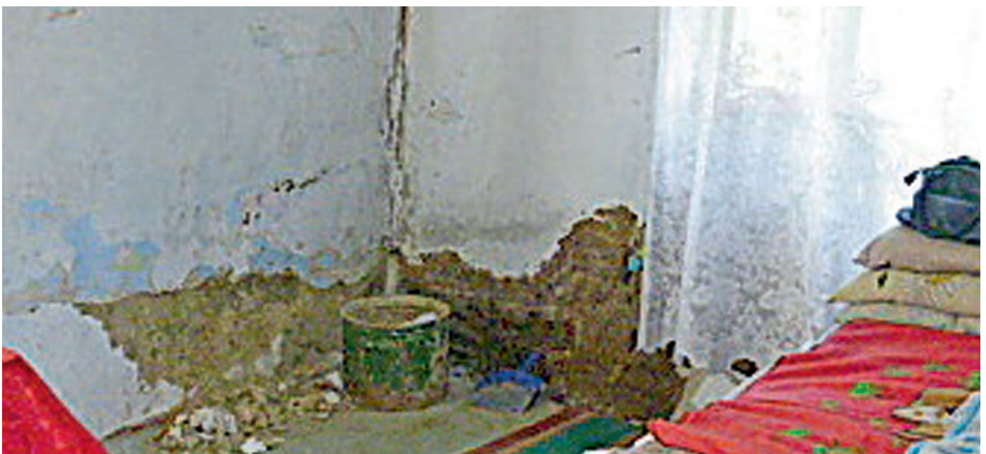
■ Wohnraum der Familie Stachurschii. Die Wände faulen weg, es ist feucht und schimmelig an den Wänden. Bilder: Hartig
