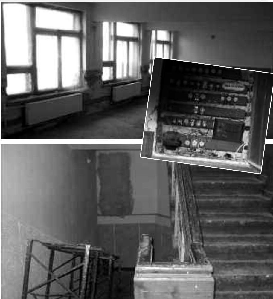
■ Der vormals desolate Kindergarten, welcher jahrelang einer anderen Funktion diente, wurde entkernt und grundlegend renoviert.
